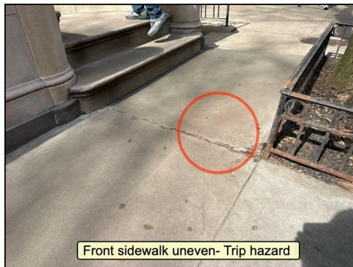
Uneven (trip hazard)
